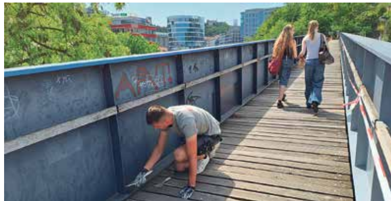
NELEGÁLNÍ výtvary sprejerů nelikviduje Praha 5 v rámci svého Antigraffiti programu jen na budovách. Nedávno přistoupila k odstranění čmáranic z lávky, která spojuje park Sacre Coeur a nákupní centrum Nový Smíchov. Foto: MČ Praha 5
