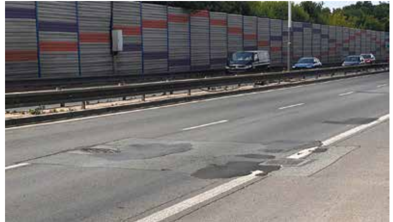
STAV VOZOVKY se dramaticky zhoršil po letošní zimní sezoně a vykazuje vysoký stupeň opotřebení s výskytem hlubokých vyjetých kolejí a výtluků. Foto: TSK Praha
