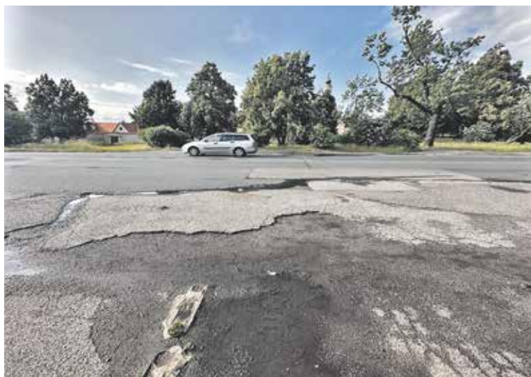
DO VÝČTU letních oprav patří také poničená Karlovarská. Foto: TSK
